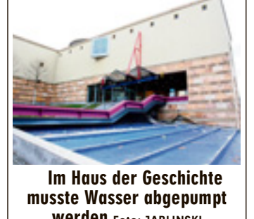
Im Haus der Geschichte musste Wasser abgepumpt werden. Foto: JABLONSKI
